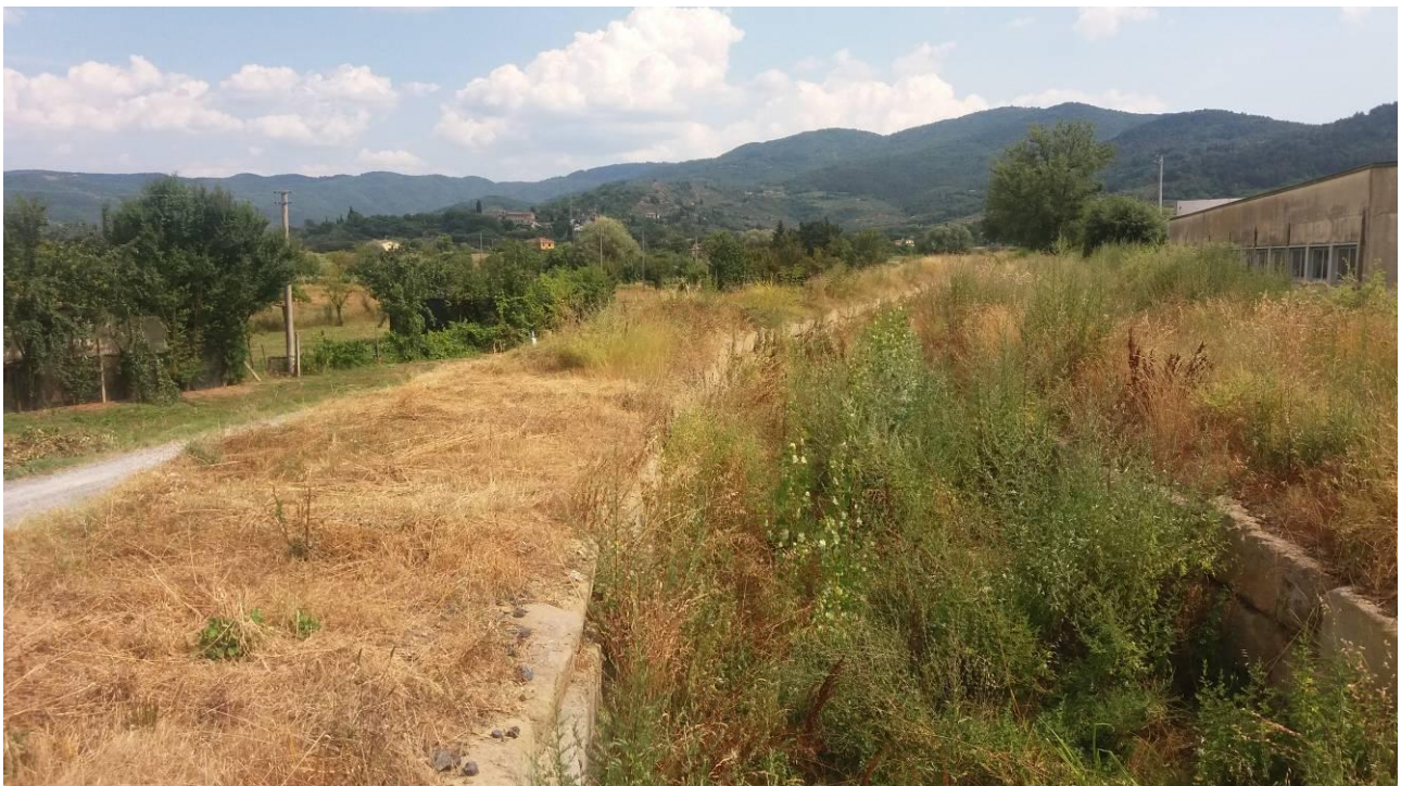
Figura 22: Torrente Sellina. Si tratta di un sistema fluviale con alveo pensile sopraelevato rispetto alla piana circostante e con argini artificiali per il contenimento dei fenomeni di esondazione.
