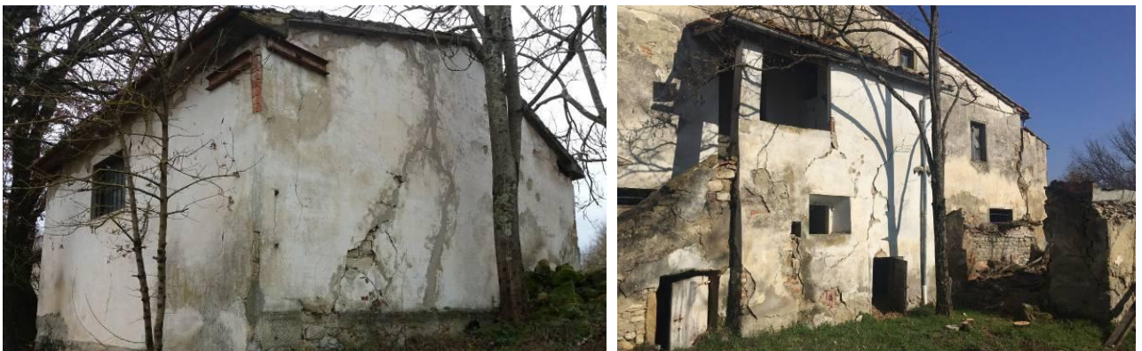
Figura 44: Settore di Monte sopra Rondine: i movimenti di scivolamento rotazionale che interessano in diverse zone le coltri colluvio – alluvionali plio-quadernarie, hanno interessato anche la porzione superiore del centro abitato con evidenze di crepe e fratture negli edifici storici e recenti, ad indicare un fenomeno lento e tutt'oggi attivo.
