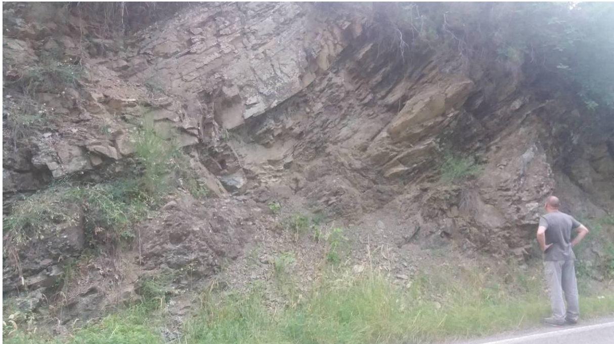
Figura 5: scarpata su un taglio stradale lungo la SP Palazzo del Pero (Loc. Molin Nuovo), scolpita sulle formazioni pelitiche riferibili al Membro arenaceo pelitico - FAL3 – dell'Unità di M. Cervarola.
