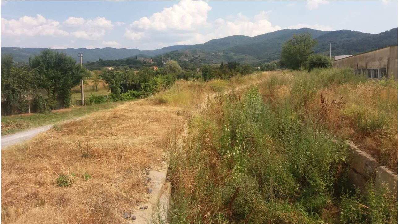
Figura 9: Torrente Sellina. Si tratta di un sistema fluviale con alveo pensile sopraelevato rispetto alla piana circostante e con argini artificiali per il contenimento dei fenomeni di esondazione.
