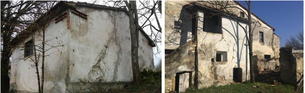
Figura 19: Settore di Monte sopra Rondine: i movimenti di scivolamento rotazionale che interessano in diverse zone le coltri colluvio – alluvionali plio-quadernarie, hanno interessato anche la porzione superiore del centro abitato con evidenze di crepe e fratture negli edifici storici e recenti, ad indicare un fenomeno lento e tutt'oggi attivo.
