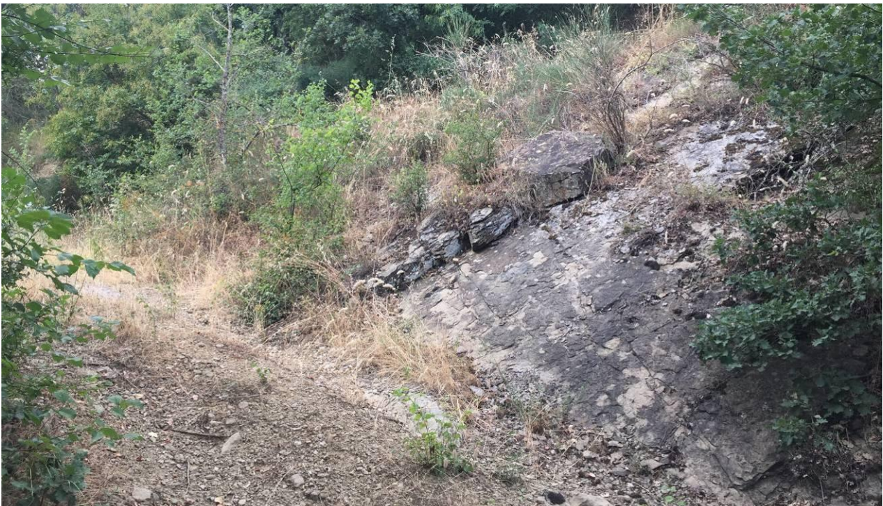
Figura 15: versante a franapoggio con superficie di strato soggetto a movimenti di scivolamento planare di blocchi di roccia
